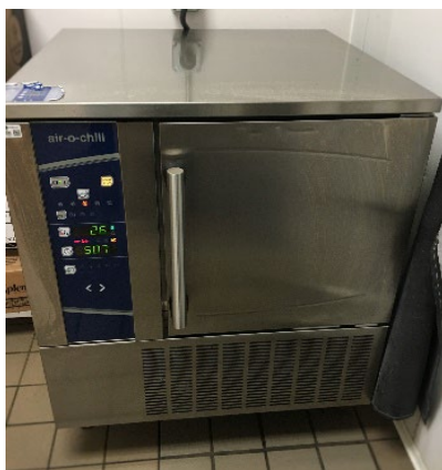
Exterior del enfriador rápido
