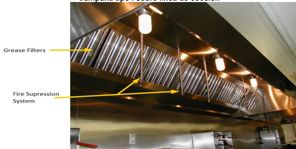
Campana tipo I sobre línea de cocción
