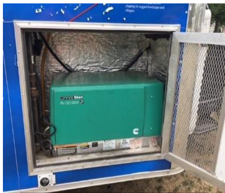
安装在单位外部隔间的发电机
