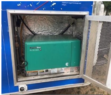
安装在单位外部隔间的发电机
