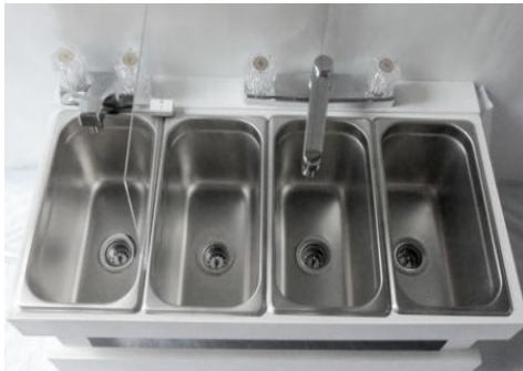
作为 3 格水槽一部分的固定洗手台
