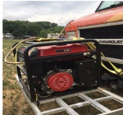
发电机安装在单位外部
